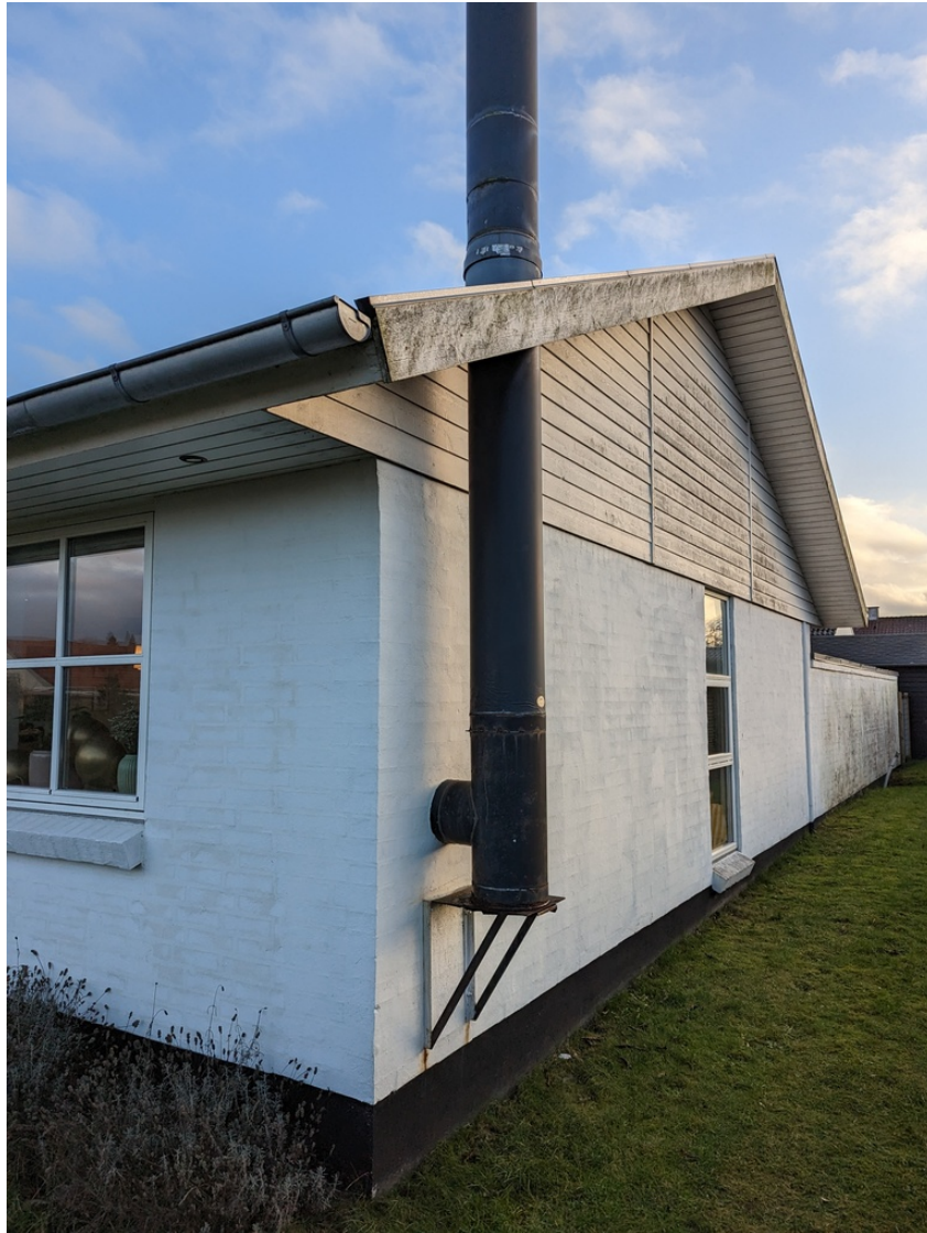
Figure 7: Skorsten ønskes fjernet og hul lukket. Vestlige facade, bemærk igen manglende ventilation.
