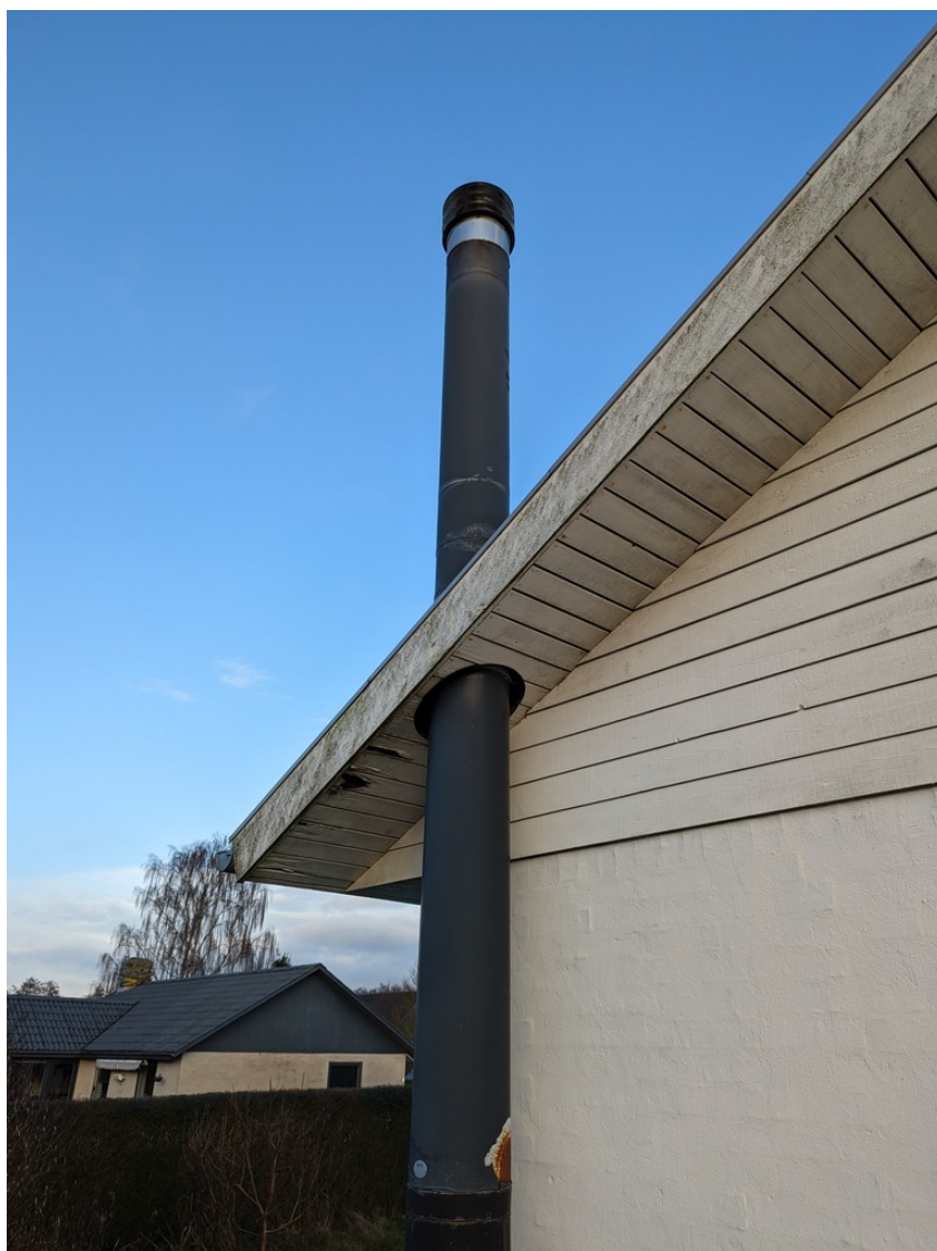
Figure 8: Bemærk råd i træ under skorsten
